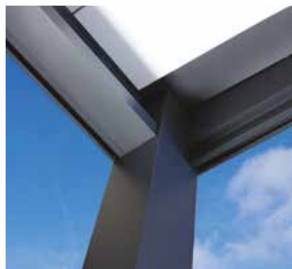
Évacuation des eaux via les gouttières placées dans les poteaux
